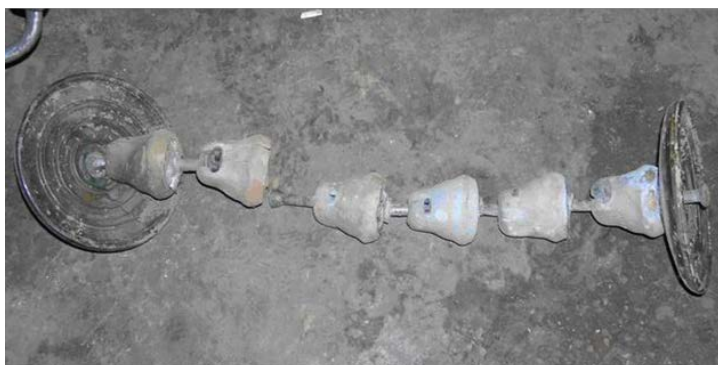
Рис. 2. Разрушение гирлянды изоляторов с разрывом шапки
